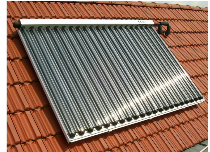
Abb. 17: Röhrenkollektoren einer Solarthermieanlage
